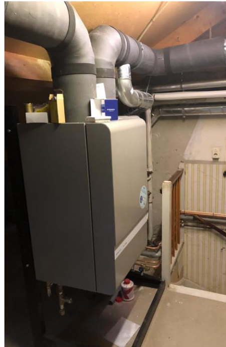
Actual installation tenant's home
