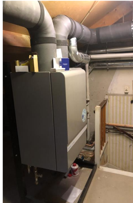
Actual installation tenant's home
